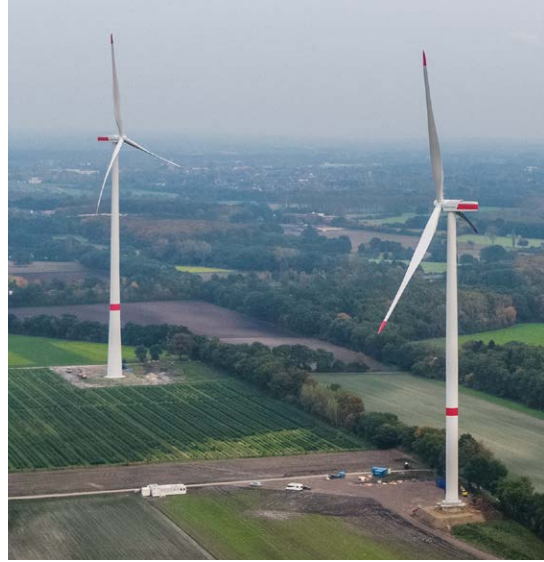
Windpark in Schermbeck-Rüste.
